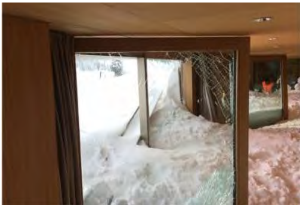
Abbildung 96: Die grössten Schäden wurden an der Südseite des Hotels verzeichnet, wo fünf Fenster und eine Glastür beschädigt wurden (Foto: H. Schoop, 10.01.2019).
