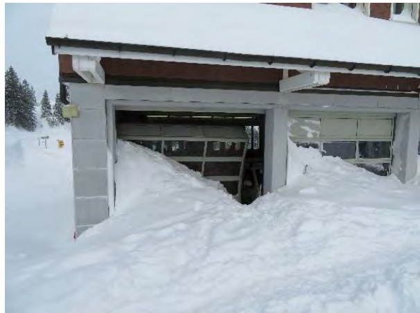
Abbildung 99: Eingedrückte Garagentore des Hauses Girenspitz (Quelle: Ereignisanalyse tur gmbh)
